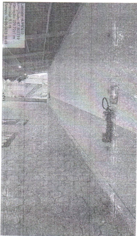
IMAGEM 11: LOCAÇÃO DE EXTINTORES.
