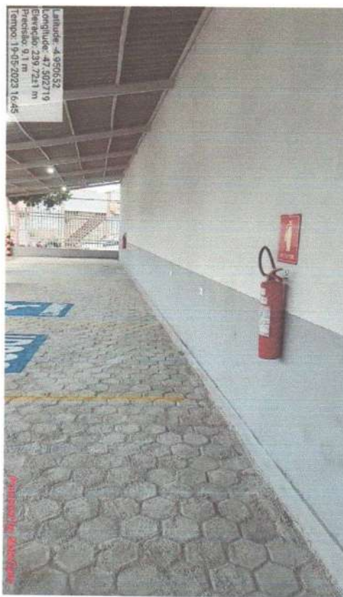
IMAGEM 12: LOCAÇÃO DE EXTINTORES.
