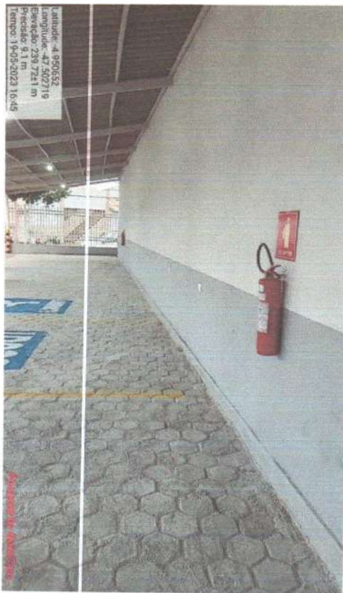
IMAGEM 11: LOCAÇÃO DE EXTINTORES.
